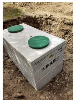
Slika 5 – Betonska septička jama
